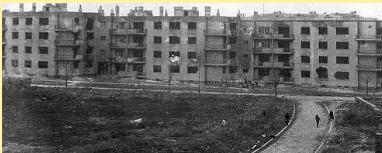
Zniszczenia wojenne – elewacja od strony ul. Potockiej (listopad 1945 r.)
